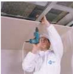
Po zmontowaniu siatki rusztu mocujemy do profili płyty gipsowo-kartonowe. Później wykańczamy spoiny.
